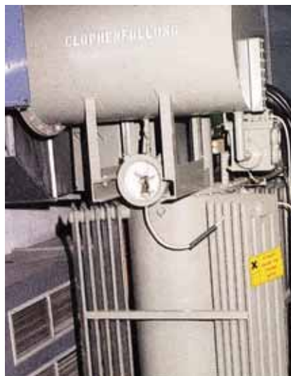
Einer von etwa 50 PCB-Trafos, die wir in Graz ent-
