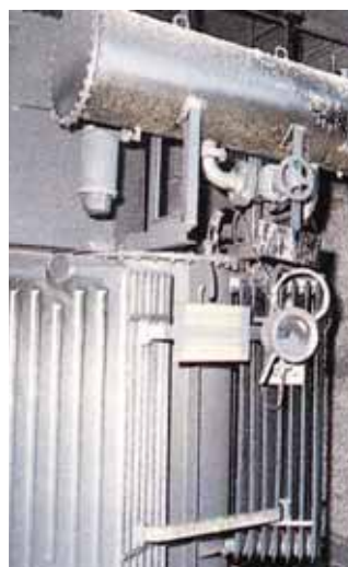
Beim Großbrand im Rigips-Werk waren zwei PCB-Trafos stark gefährdet.
